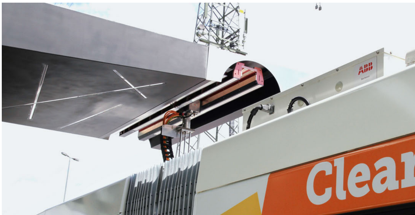
L'installation de la recharge des batteries.
